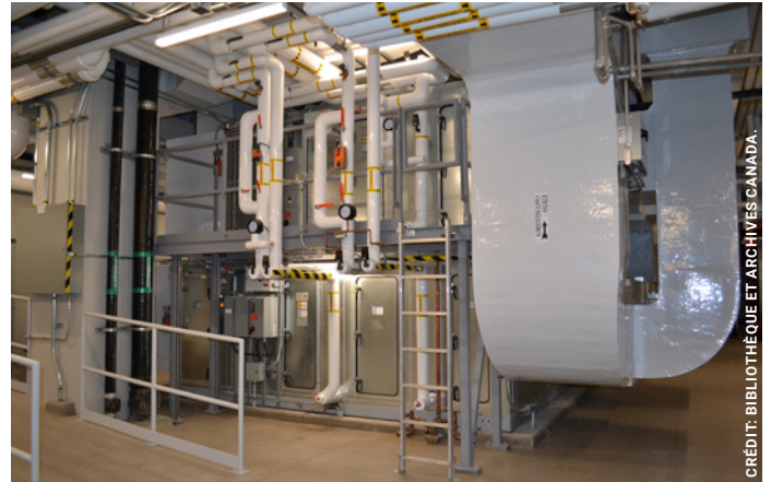
Unité de traitement d'air.
