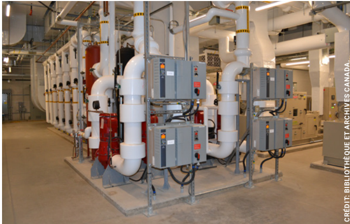
Système de pompe pour le refroidisseur.
