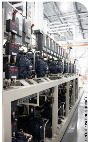
Aperçu des machines fixes électriques servant au pompage du CO 2 .
