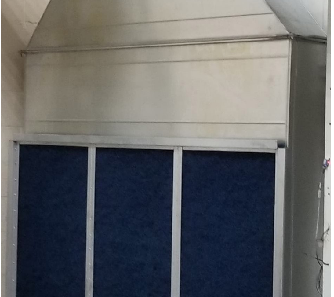
Le refroidissement localisé apporte de l'air neuf directement au poste de travail à une vitesse adéquate.
