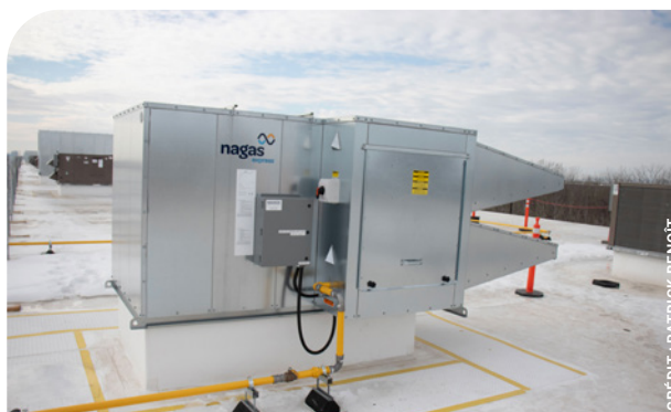
Treize unités de compensation d'air direct permettent de maintenir et de respecter les normes en ce qui concerne la qualité de l'air intérieur des bâtiments.
