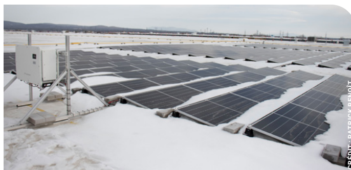
L'installation de 750 panneaux photovoltaïques vise à combler 5 % des besoins en électricité du projet. Cet ajout d'équipement fait partie des critères d'innovation considérés pour l'obtention des certifications LEED et BCZ.
