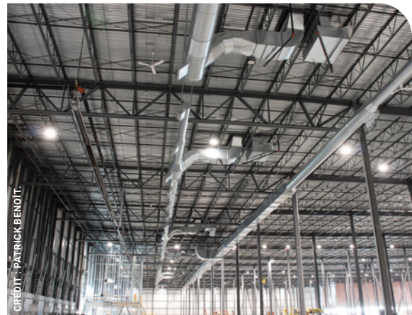
Aperçu du vaste réseau de distribution d'air à l'intérieur des bâtiments du projet.
