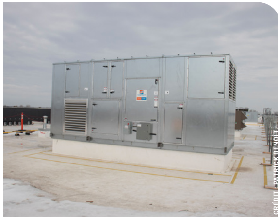
Onze unités de récupération de chaleur à cassettes installées sur le bâtiment A permettent de traiter un volume de 70 000 CFM d'air comparativement aux unités de compensation d'air direct qui traitent un volume de 130 000 CFM d'air.
