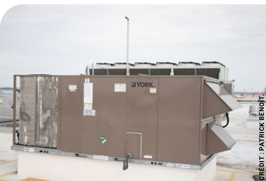
Le chauffage et la climatisation des bâtiments sont assurés par ce type de thermopompe air-air opérable jusqu'à une température de -10 degrés C, avec un coefficient de performance de 3 en moyenne.
