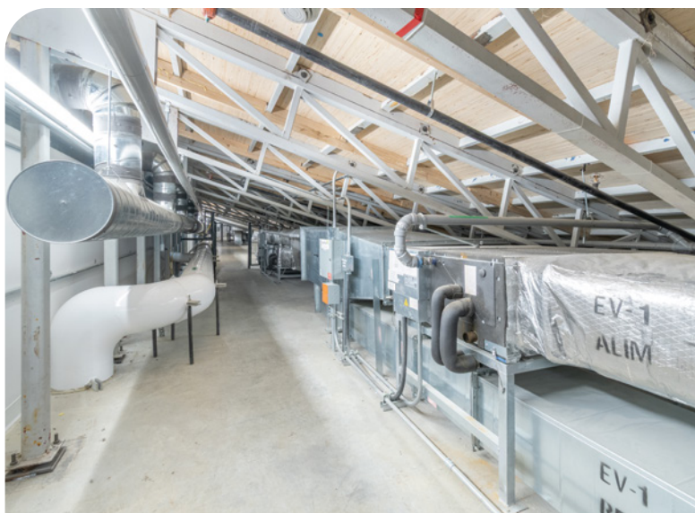
Système de ventilation installé sous la piste du vélodrome.
