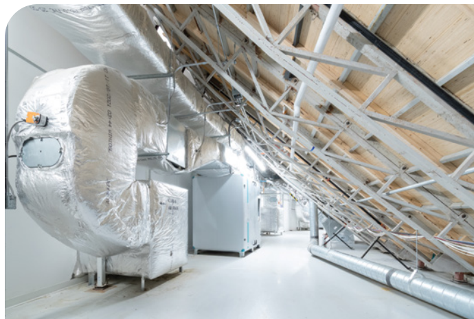
Unité de traitement de l'air avec l'une des cinq roues enthalpiques sous la piste.
