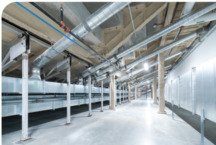
Système de ventilation et de chauffage par déplacement d'air localisé sous la piste.
